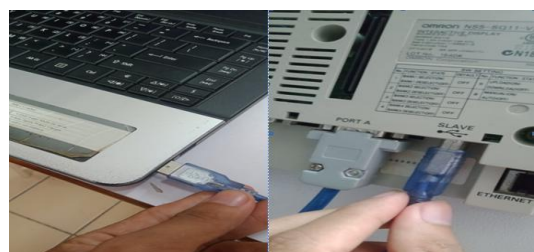
Gambar 5. Pemasangan Kabel USB PC ke HMI
